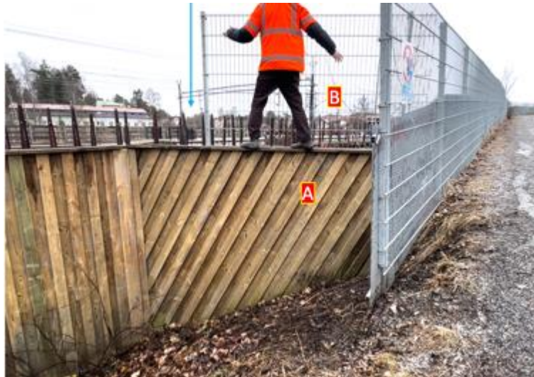
Figur 13. Test av intrångsskydd vid platsbesök av barriär på Järna station. Det är lätt att klättra upp på det 1350 mm höga bullerplanket (A) trots att det kompletterats med ny stålplåtspanel (B). Ovankanten på bullerplank fungerar att gå på. Genom att gå på ovankanten kan man runda stålplåtspanelen och klättra ner på baksidan av bullerplanket (blå pil).
