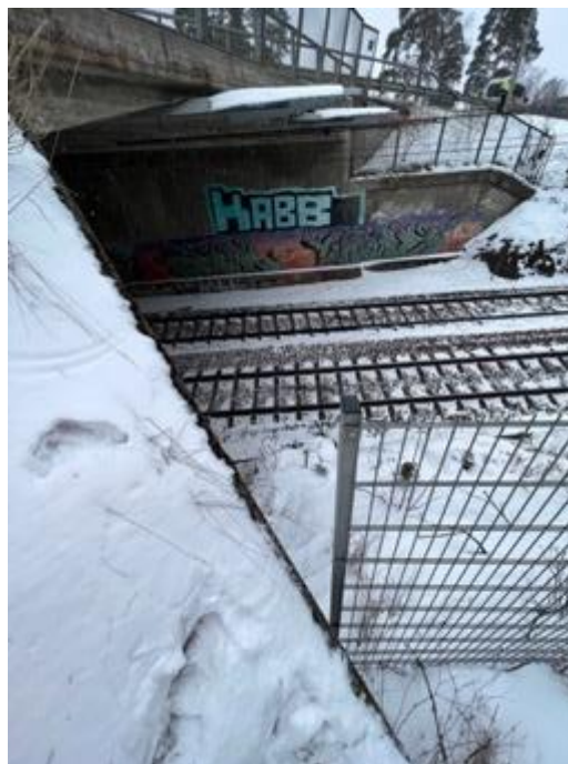
Figur 16. Ny stål nätspanel vid anslutning till bro som inte uppfyller kriterierna enligt K29222: "Anslutning av stängsel till grind eller annan konstruktion ska utföras så obehöriga inte kan tränga sig mellan konstruktion och stängsel in på spårområde i TRVINFRA-00008, Personskydd mot Järnväg"
