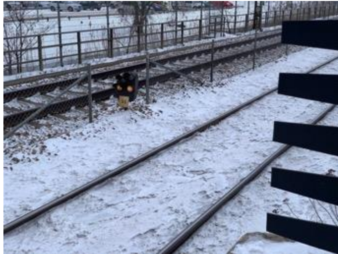
Figur 17. Hål i spärrstaketet på grund av signal vid södergående spår, Upplands Väsby driftplats. Vid byggandet av spärrstaket borde man sidoförskjutit signalen så att staketet förblev obrutet, eller bygga enligt Figur 18.
