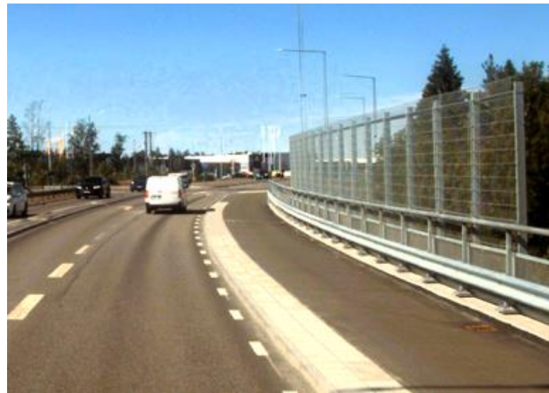
Hoppskydd på väg 646 på bro över väg 222 vid trafikplats Gustavsberg
